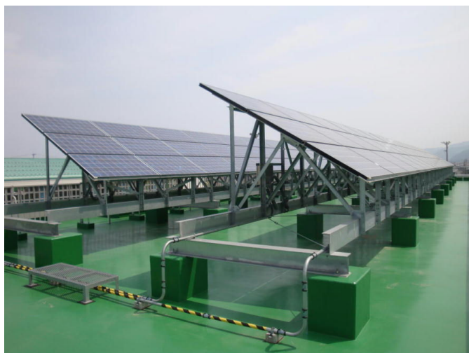
〔北校舎屋上にある太陽光パネル 〕
